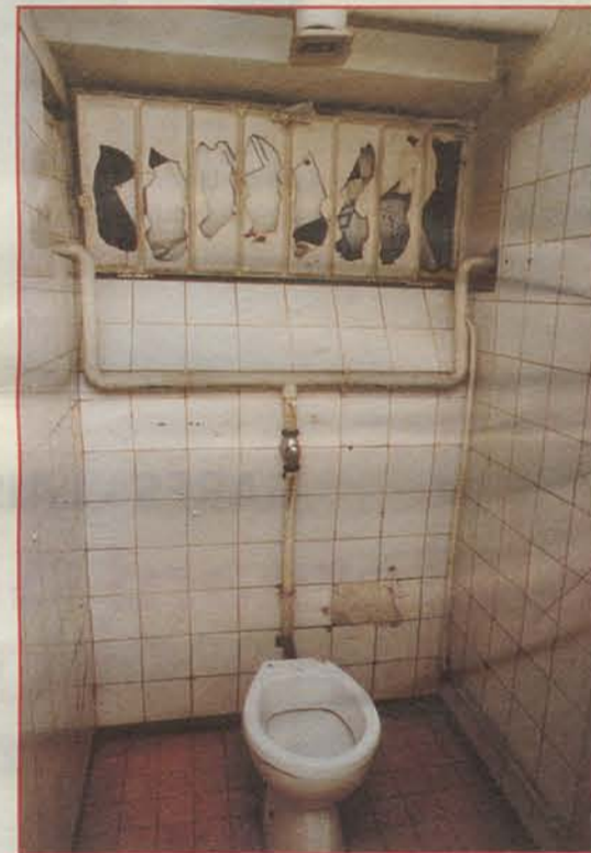
Des lieux dégradés : les toilettes
