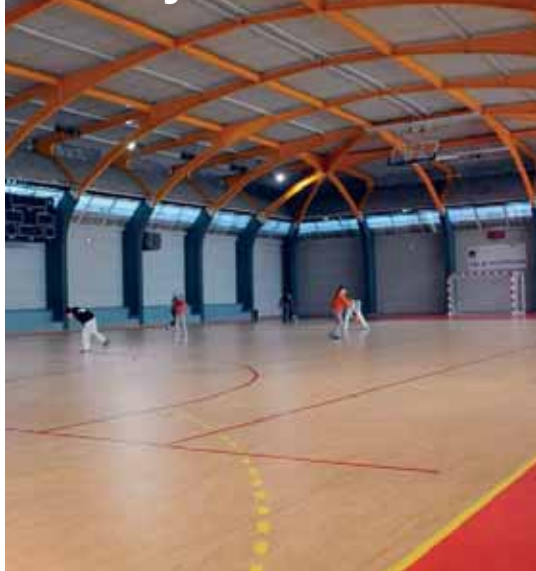
Le gymnase Busnel refait à neuf. Le sol est désormais en caoutchouc recyclable et l'étanchéité a été renforcée. Il sera inauguré le 20 mars.
