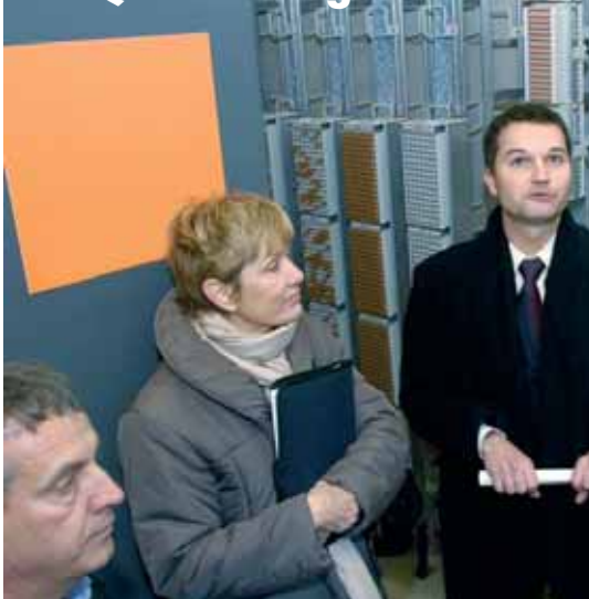
Le nouveau central téléphonique de France télécom, permet aux abonnés, reliés jusqu'à maintenant à celui d'Euro-médecine, de disposer d'un meilleur accès au haut débit.
