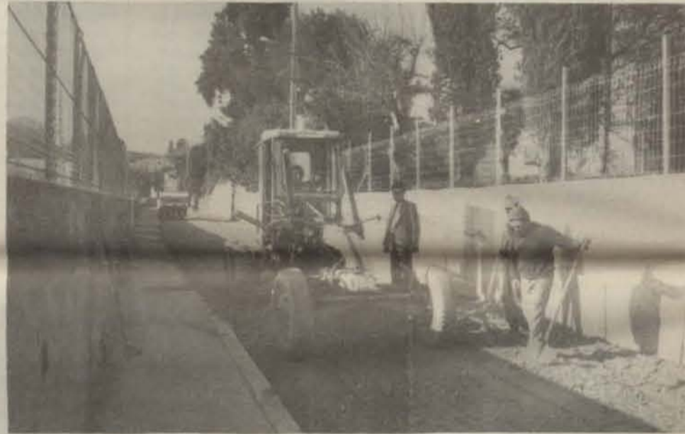
Rue Proudhon et alentours : poursuite des travaux d'assainissement du Quartier Boutonnet. Sur cette photo, les travaux sont sur le point de se terminer devant l'Ecole Militaire d'Administration.
