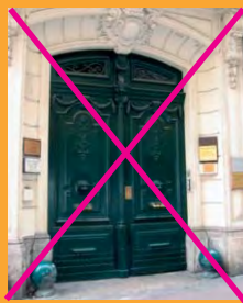
Porte d'entrée avec multiples plaques professionnelles hétérogènes portant atteinte au décor architectural
