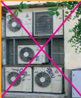
Intégration d'appareils de climatisation sans aucune grille de dissimulation
