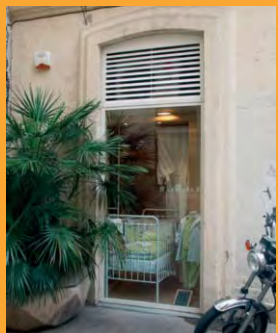
Intégration d'appareils de climatisation derrière une grille
