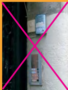
Porte d'entrée avec multiples boîtiers
