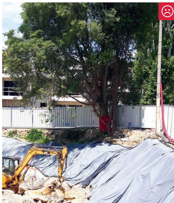
MICOCOULIER, NON RESPECT DES DISTANCES CHANTIER-ARBRE, AVENUE DU JEU DE MAIL DES ABBÉS
