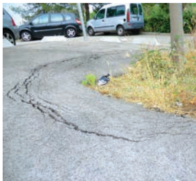
AFFAISSEMENT D'UNE FOSSE DE PLANTATION
