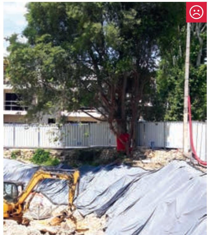
MICOCOULIER, NON RESPECT DES DISTANCES CHANTIER-ARBRE, AVENUE DU JEU DE MAIL DES ABBÉS
