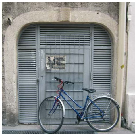
La totalité de la baie du local technique a été recouverte de ventelles en acier.
