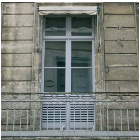
Le soubassement de la fenêtre est rainuré.
