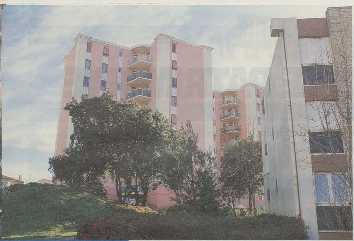
La résidence de la Pompignane a fait l'objet de travaux lourds de réhabilitation
