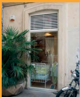
Intégration d'appareils de climatisation derrière une grille
