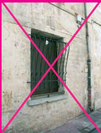
Grille de protection à barreaudage creux posée à l'envers
